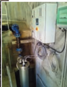
Installation UV à Villemartin
