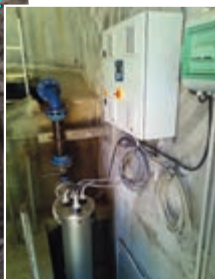
Installation UV à Villemartin
