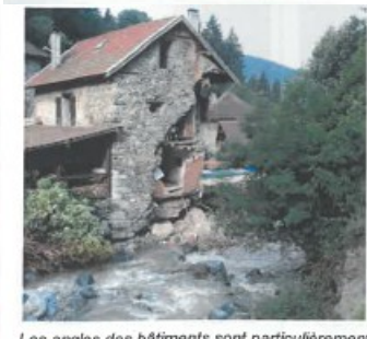
Les angles des bâtiments sont particulièrement menacés d'affouillement en raison des survitesse induites par la concentration des écoulements.
