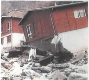
La ruine des constructions peut notamment intervenir par sapement des fondations.
